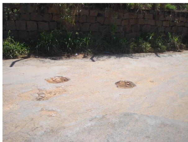
Figura 5 Vista da pista com buracos (E)
