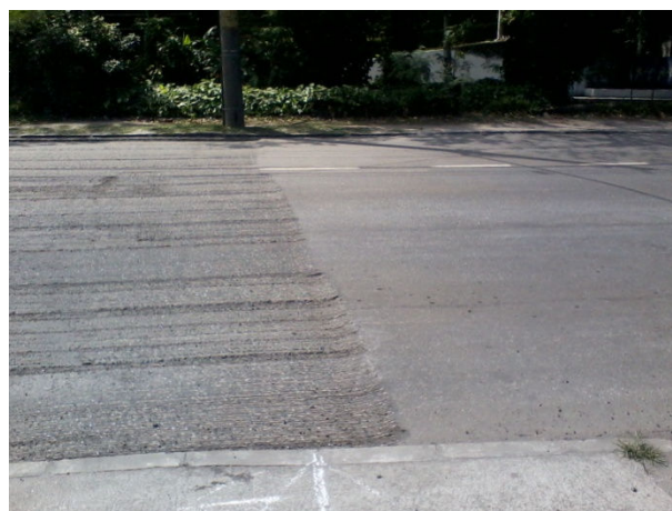
Figura 4 – Vista do degrau gerado pela fresagem do pavimento (D)
